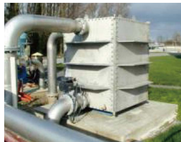
プロセス排水の熱回収(溶接型PHE)
