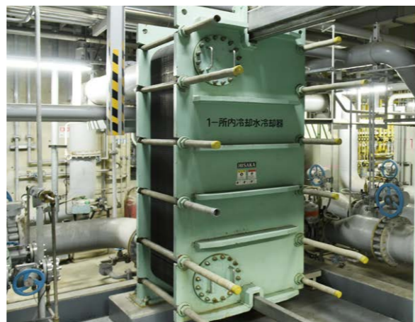
発電プラントの軸受冷却水の冷却
